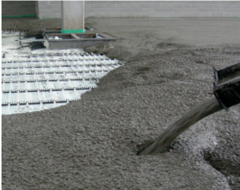
Storten van beton met toevoeging van Mapefibre NS18 om de plastische krimp tegen te gaan
